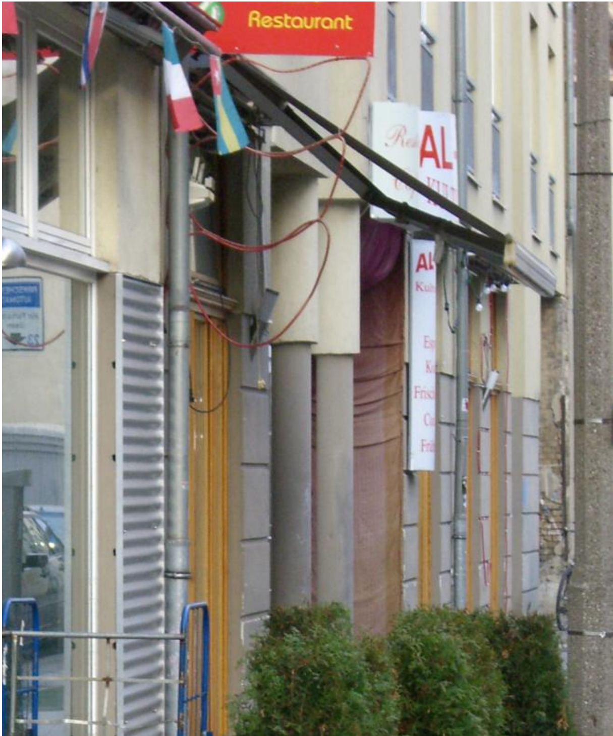
Abbildung 4: Die Elektrik an den Fassaden ist überwiegend verfallen, hängt herab und stellt insbesondere für Kinder eine Gefahr dar. (Feb. 2007)
